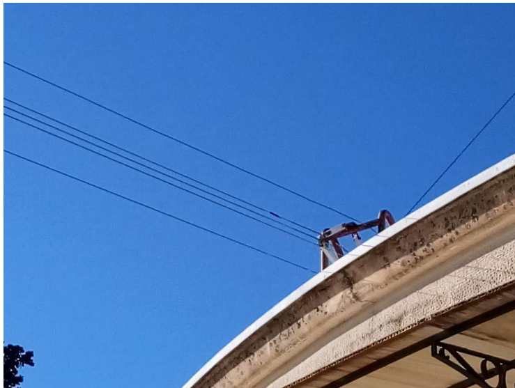
Ηλεκτροφόρα καλώδια υψηλής τάσης, μεταφέρουν το σήμα στους ιστούς εκπομπής.
