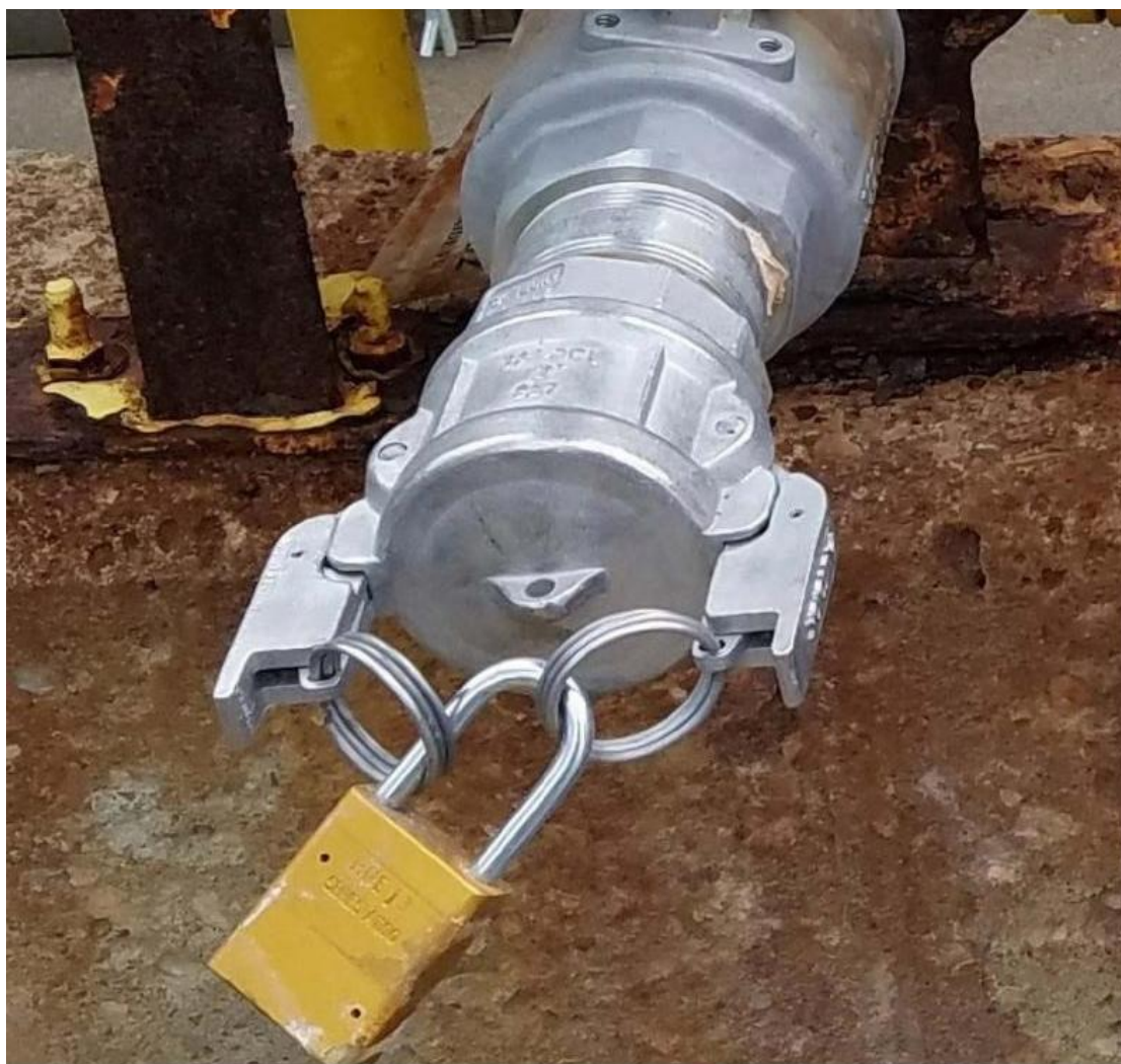
Εικόνα 5: Ένα κλειδωμένο καπάκι ακροδέκτη σύνδεσης σε μια γραμμή πλήρωσης στην περιοχή Mod B (Πηγή:CSB)
