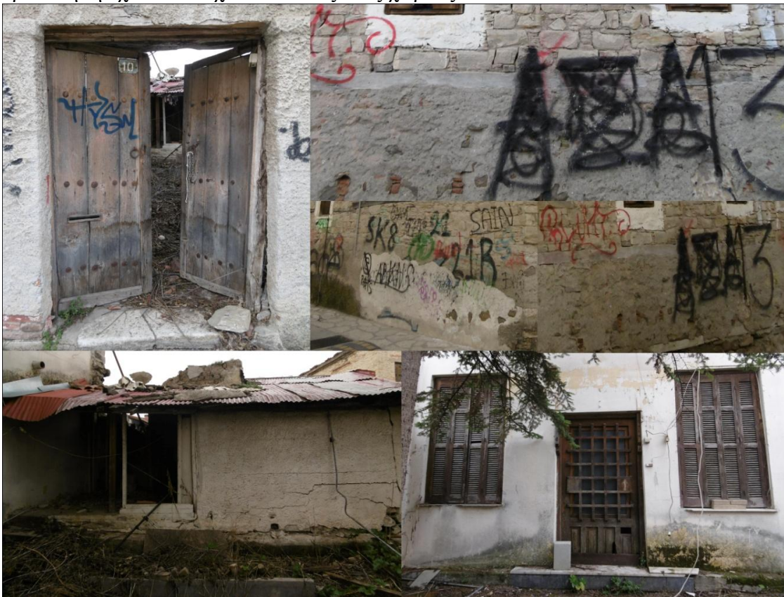
Εικόνα 19: Η ξύλινη αυλόπορτα του κτίσματος. Εικόνα 20, Εικόνα 21, Εικόνα 22: Παρεμβάσεις και φθορές στην πρόσοψη του κτηρίου. Εικόνα 23: Το παράκτισμα εσωτερικά της αυλής. Εικόνα 24: Η είσοδος του κτίσματος. Πηγή: Προσωπικό Αρχείο.
