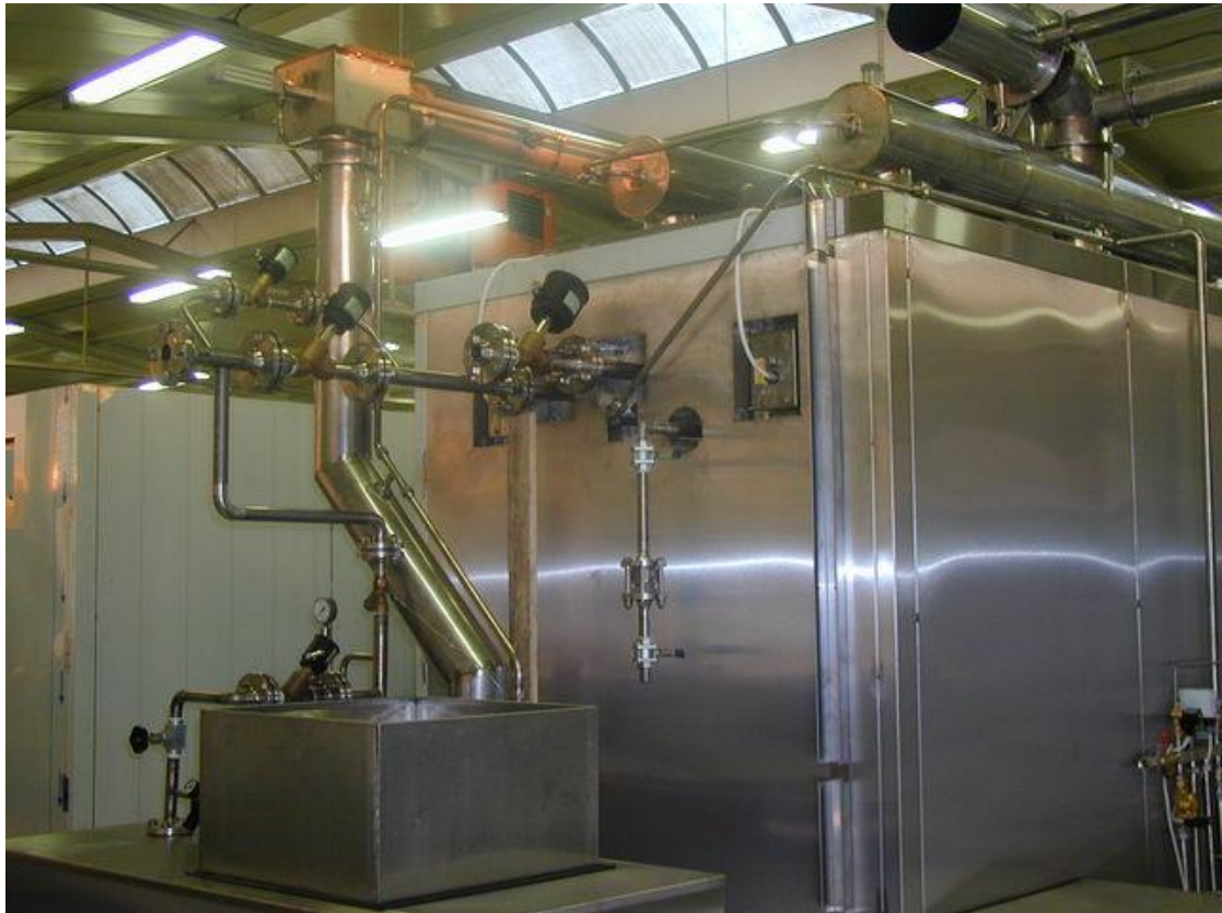
Εικόνα 4.9. Γεννήτρια καπνού ατμού
