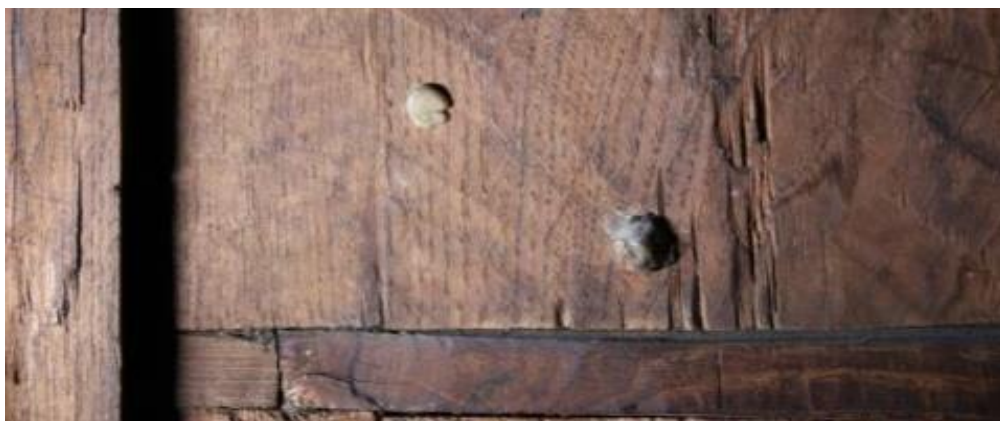
Εικόνα 34. Λεπτομέρεια εκδορών, μεταλλικού συνδέσμου και επικαθήσεων κεριού επάνω στην επιφάνεια του ξύλου (Πηγή: Χρ. Καρύδης)
