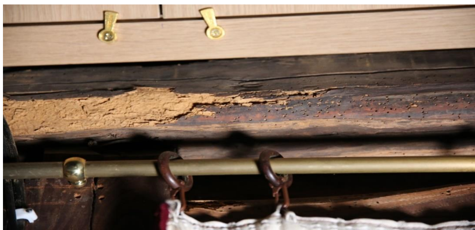
Εικόνα 29. Λεπτομέρεια της απώλειας υλικού, λόγω σαθροποίησης της επιφάνειας του ξύλου στο κεντρικό δοκάρι στήριξης στην πίσω όψη (Πηγή: Χρ. Καρύδης)
