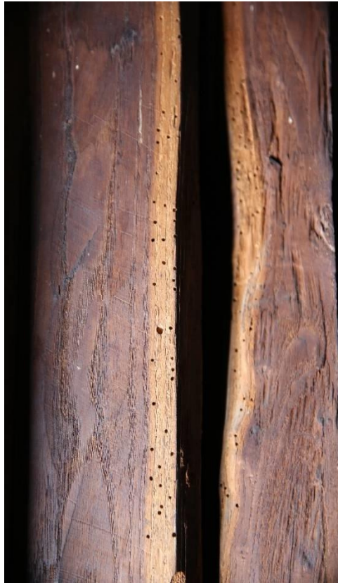
Εικόνα 32. Λεπτομέρεια από τα δοκάρια στήριξης, τα οποία εμφανίζουν προσβολή από ξυλοφάγα έντομα και ενδιάμεσο κενό, λόγω κατασκευής (Πηγή: Χρ. Καρύδης)
